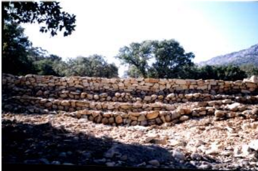
شکل ۳. یکی از سدهای اصلاحی آبراهه تنگ تیر
