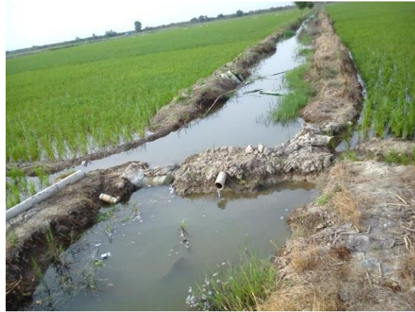
شکل ۳. ایجاد بند و آبیگری از زهکش های طرح در کرت های انتهایی، پروژه تجهیز و نوسازی اراضی اسماعیل کلا، جویبار، مازندران
